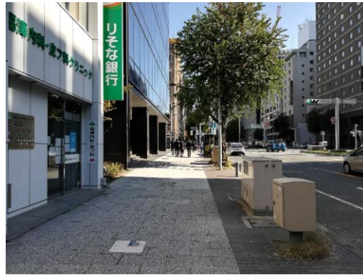
歩道上の地上機(錦通)
